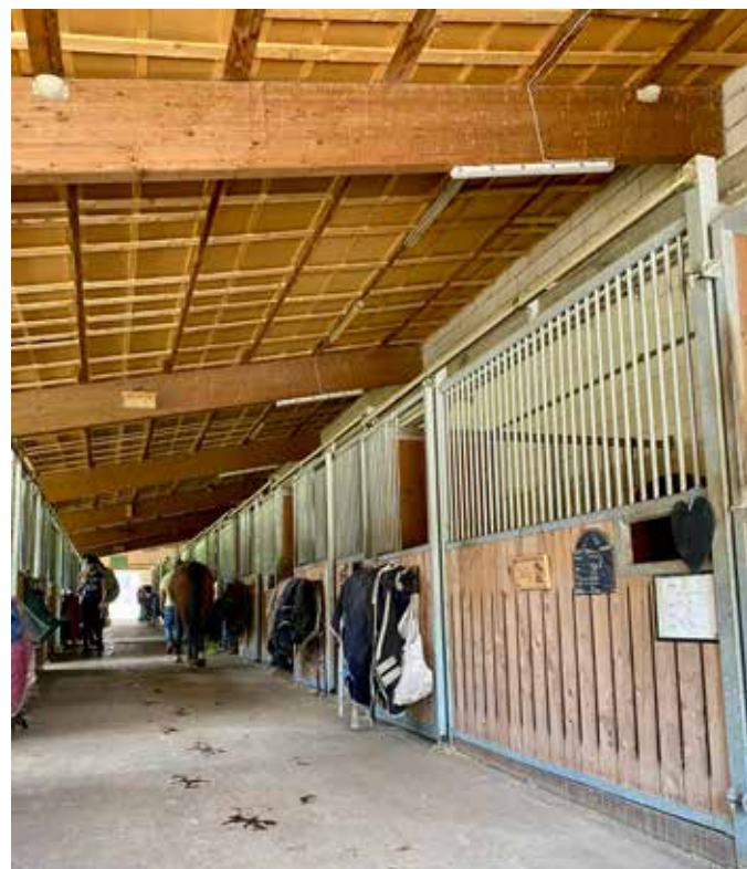
An den Querbalken der Stallgasse hat der Verein bereits energiesparende LED-Röhren angebracht.
